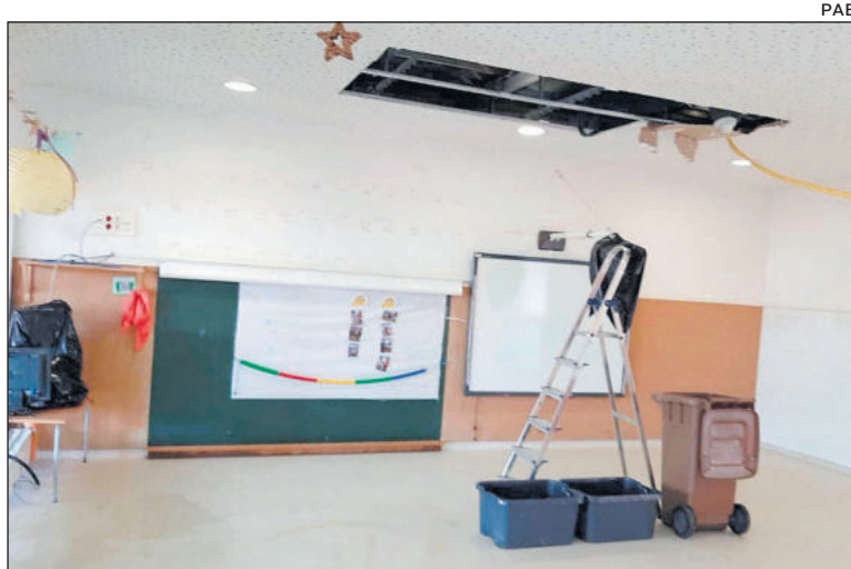
FORAT Les pluges van provocar importants desperfectes a la coberta
